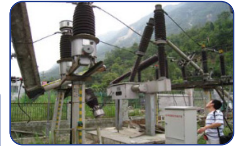
نمونه شکست تجهیزات پست‌های انتقال در زلزله
